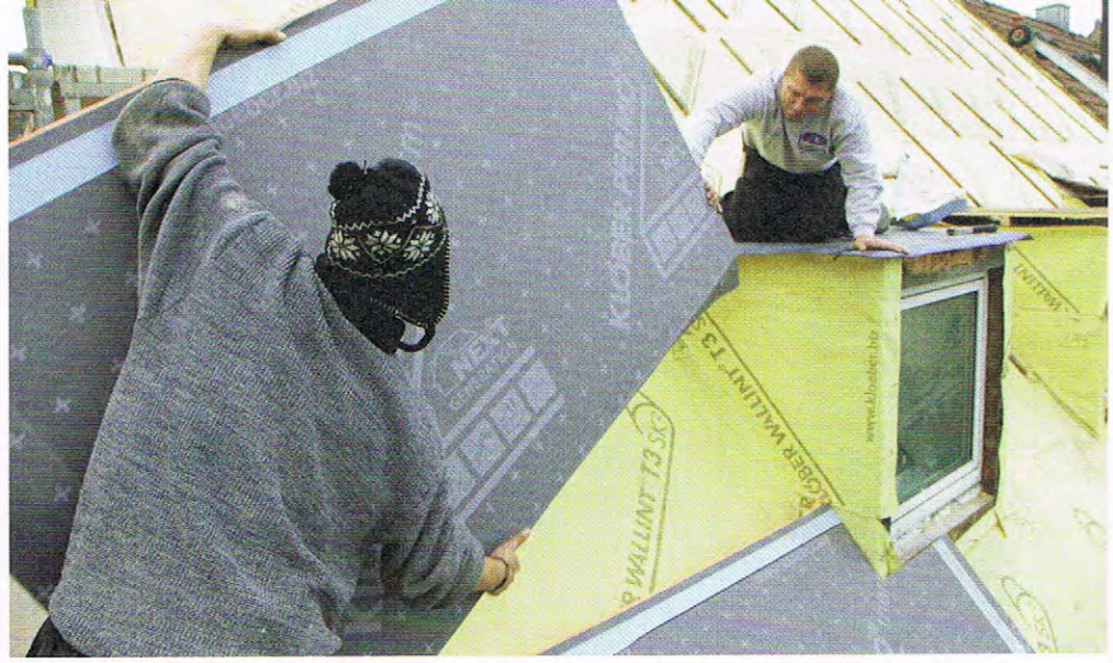
▲ Auf der Luft-/Dampfsperre kommt hier ein Hochleistungsdämmstoff zum Einsatz, der sich wärmebrückenfrei verlegen lässt. Statisch berechnete Schubschwellen nehmen die Last auf
