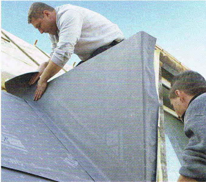
▲ Mit den abgestimmten Elementen eines Dämmsystems ergeben sich gerade in der Dachsanierung wirtschaftliche Lösungen
