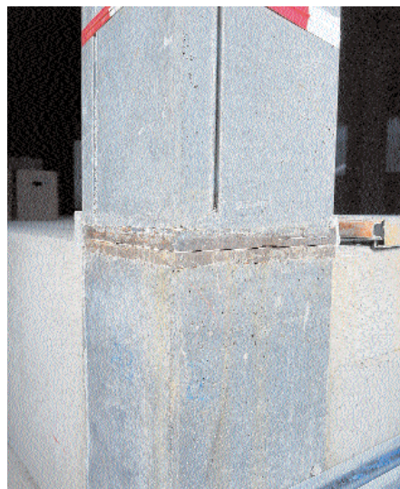
Bild 7: DYWIDAG-Kompaktknoten einer eingebauten Fertigteilstütze
