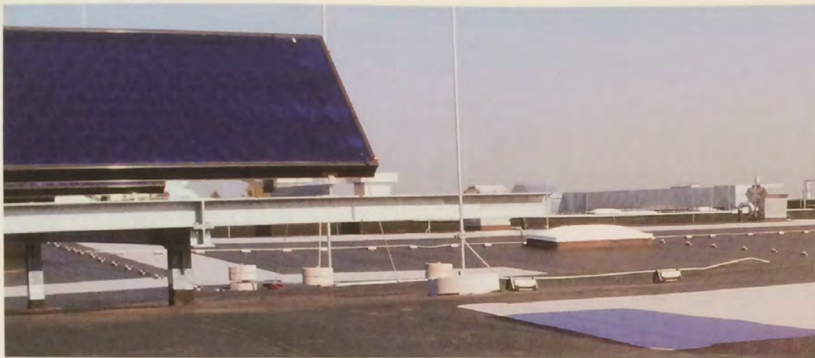
Helle Dachbahnen markieren die Wartungs- und Servicewege zu den aufgeständerten Solaranlagen.
