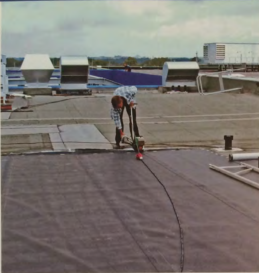
Das Projekt wurde in viele Teilabschnitte aufgeteilt. Mit dem Setzautomaten werden die Befestiger in vorgegebener Anzahl im überdeckten Bahnenrand gesetzt.
