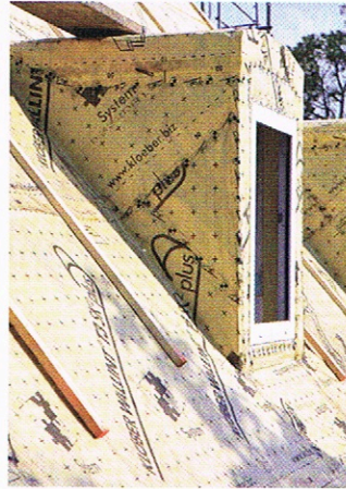
Einfacher und sicherer ist es, die gesamte Konstruktion luftdichtend „einzupacken“ und anschließend zu überdämmen
